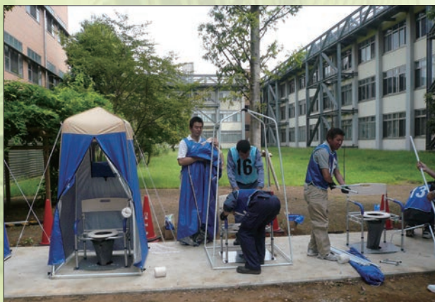
災害用トイレ便器(洋式タイプ)の設置演習(C14側5台)
