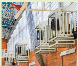
体育館冷暖房装置(2.施設・設備の充実)
